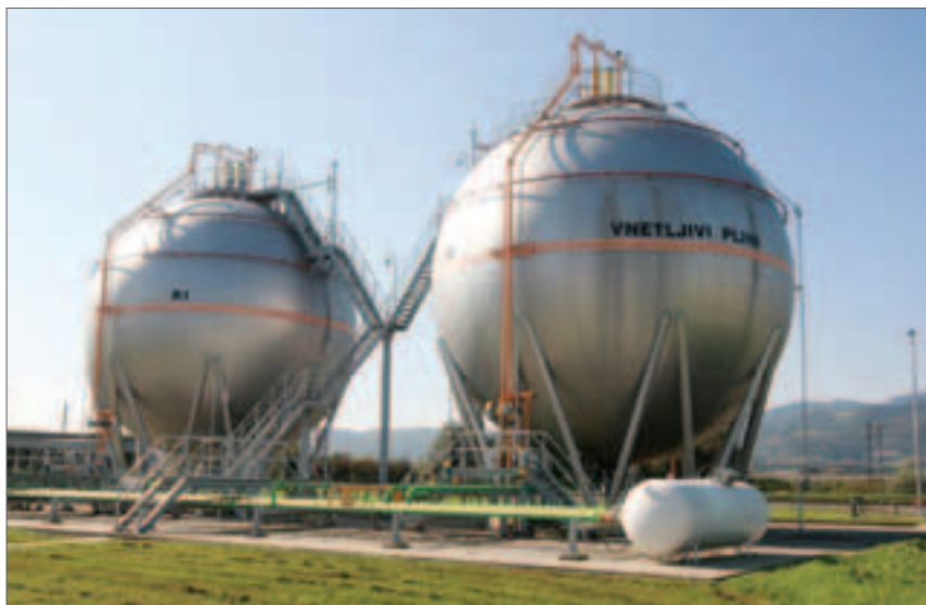
Rezervoarji za utekočinjen naftni plin v skladiščno-distribucijskem centru na Bohovi.
